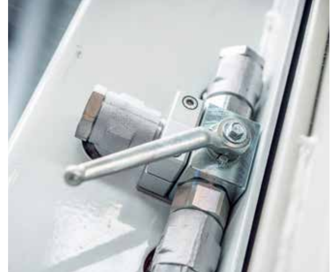
Omschakelen oliedruk lift naar vloeren gebeurt met een handbediende kogelkraan.
